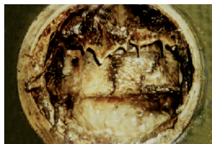
Durch Bioschlamm verstopfte Leitung
