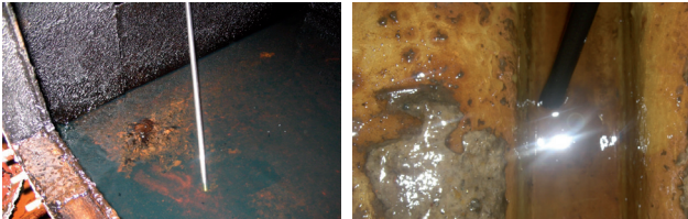
Schleimige Rückstände an Tankwänden
